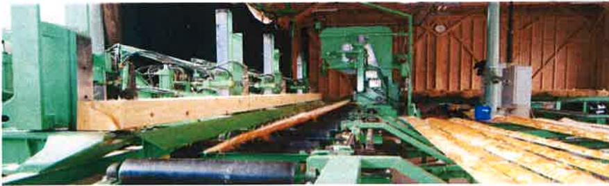
● バイオマスボイラー
